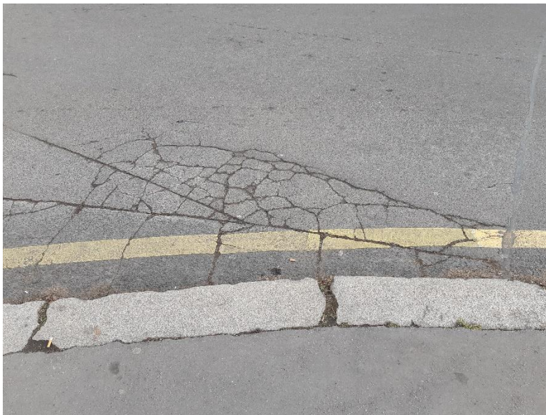
Fotografie 3: Sítové trhliny
