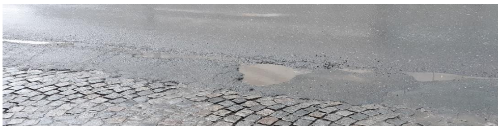
Fotografie 4: Výtluk plný vody
