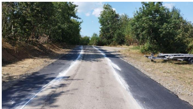
Obrázek 3: Zesílení okrajů vozovky 3
