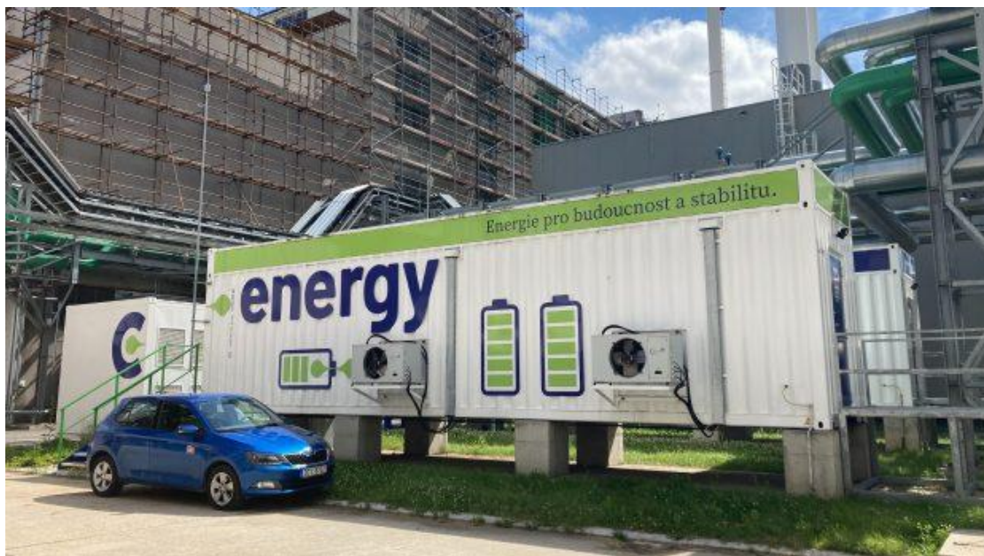
Obrázek 5 - bateriové uložení ke stabilizaci sítě (zdroj: irozhlas.cz)
