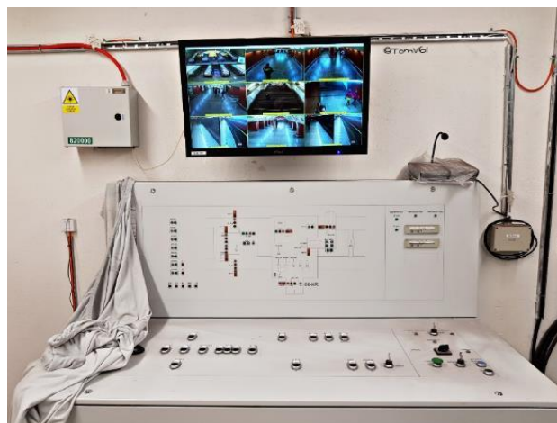
Foto 24 - Staniční řídicí pracoviště
