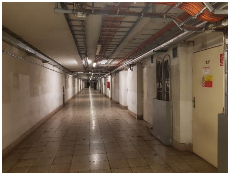
Foto 17 - Typické technické prostory stanice
