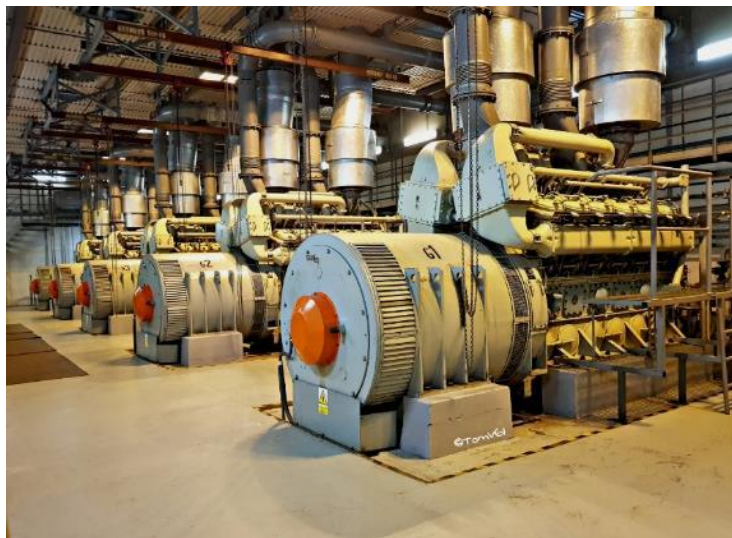
Foto 21 - Dieselaagregáty s generátory
