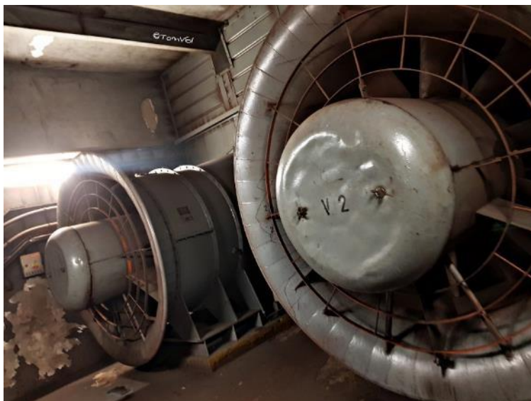
Foto 2 - Ventilátory hlavního větrání
