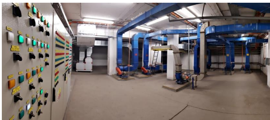
Foto 20 - Strojovna místní VZT
