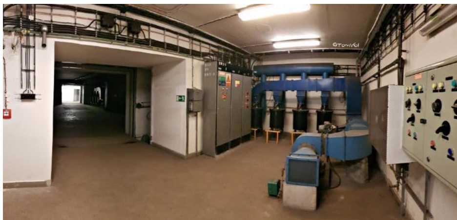
Foto 4 – KDV a vzduchové filtry
