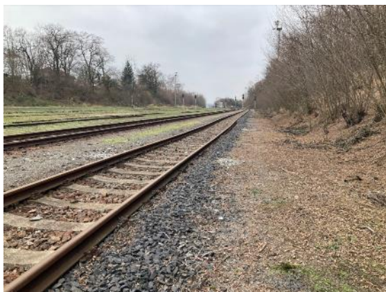
Obrázek 45, pohled směr Rakovník/Chomutov od 10. koleje, kolej je znatelně propadlá
