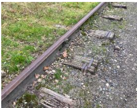
Obrázek 43, pražce koleje č. 7, detail
